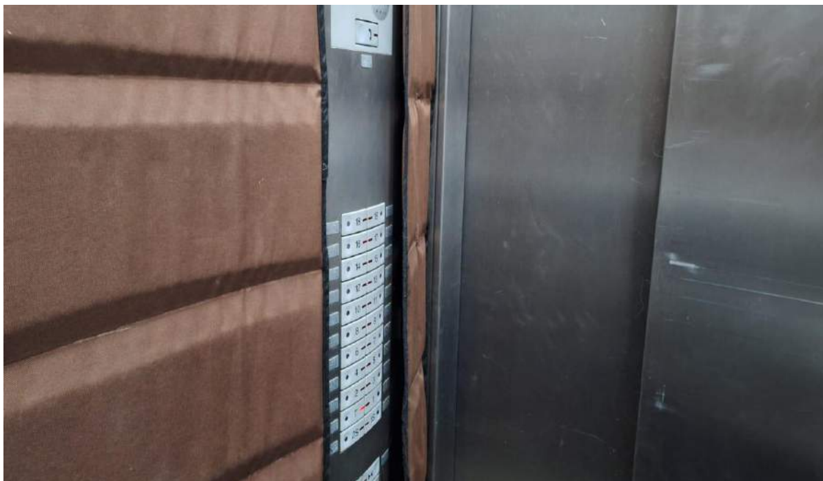
Foto 13 – Elevador de serviço
