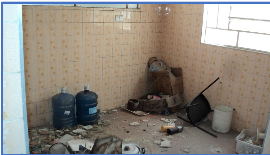
Foto: Visão de parede degradada, e cozinha com detritos.
