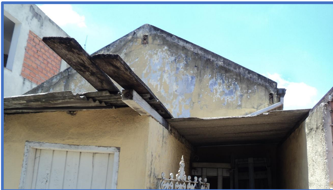
Foto: Visão dos fundos, com infiltração generalizada nas paredes.
