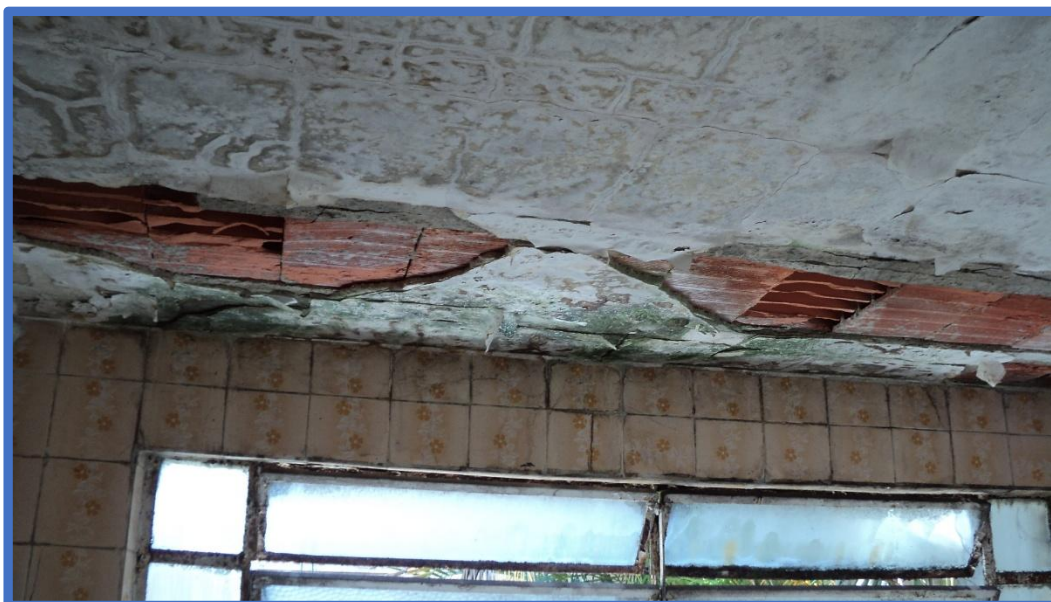
Foto: Visão da laje com ferragens e vigotas expostas, com risco de ruína.
