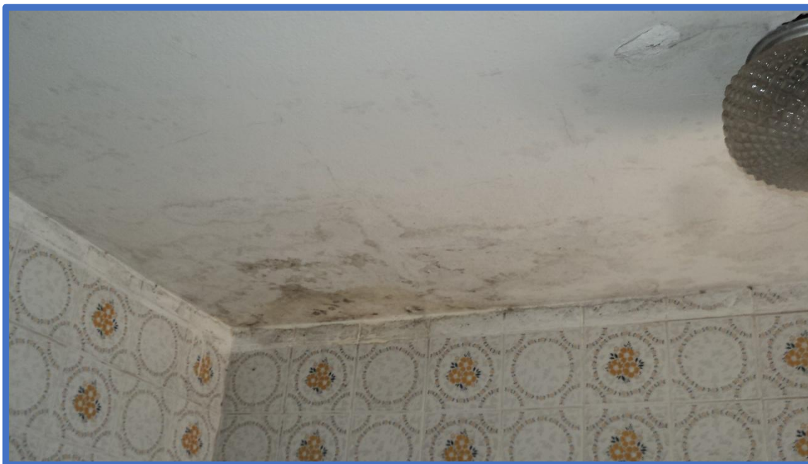
Foto: Visão de infiltração nas paredes e teto.
