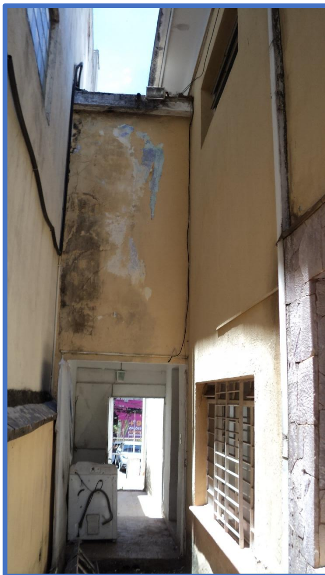
Foto: Visão do acesso lateral aos fundos, com infiltração generalizada nas paredes.
