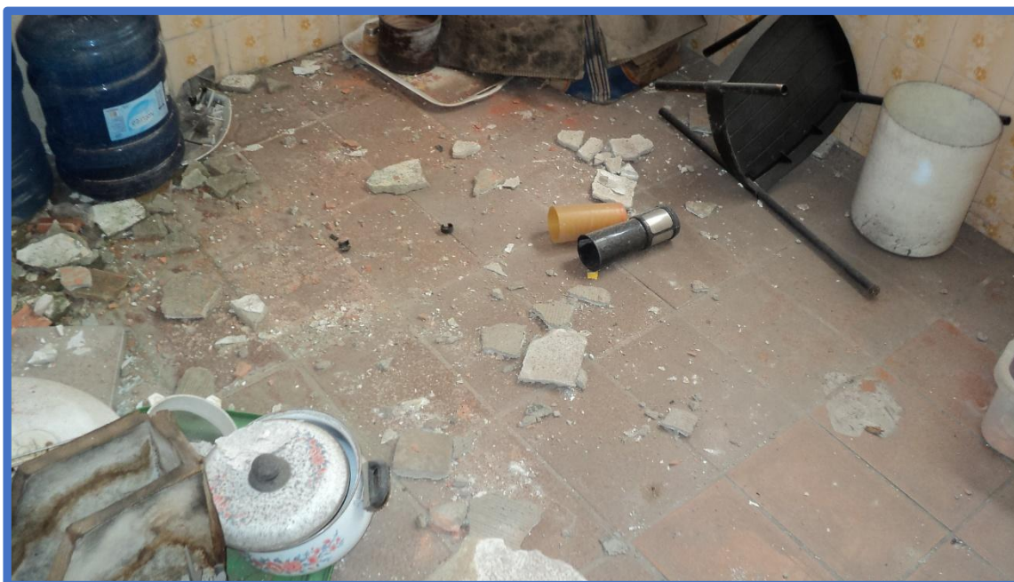
Foto: Visão da laje com ferragens expostas, com risco de ruína. Detritos no piso.
