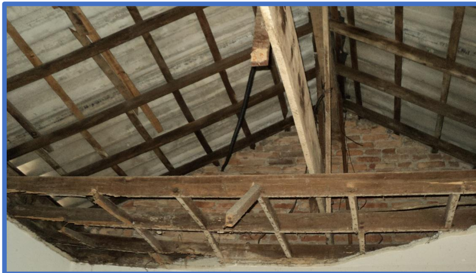
Foto: Visão do telhado, com risco de ruína.
