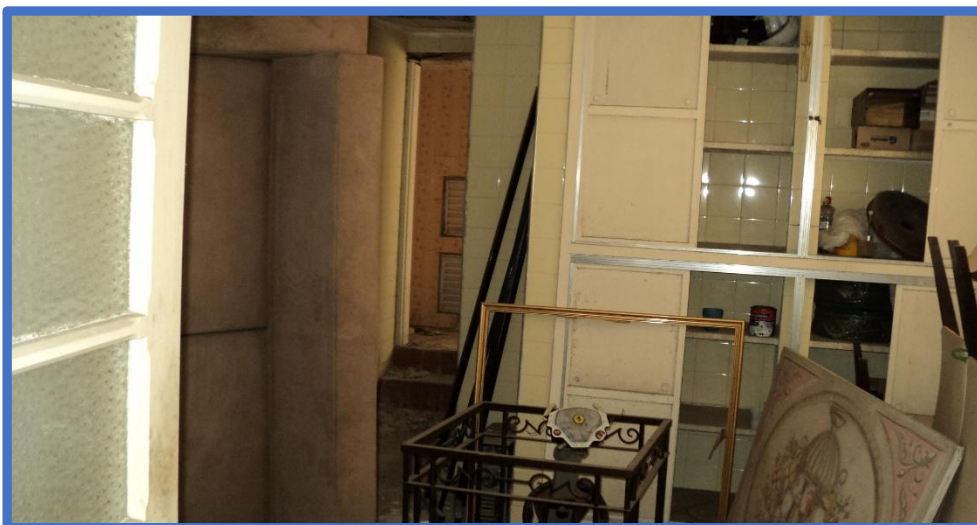
Foto: Visão da entrada, do piso, degradado.
