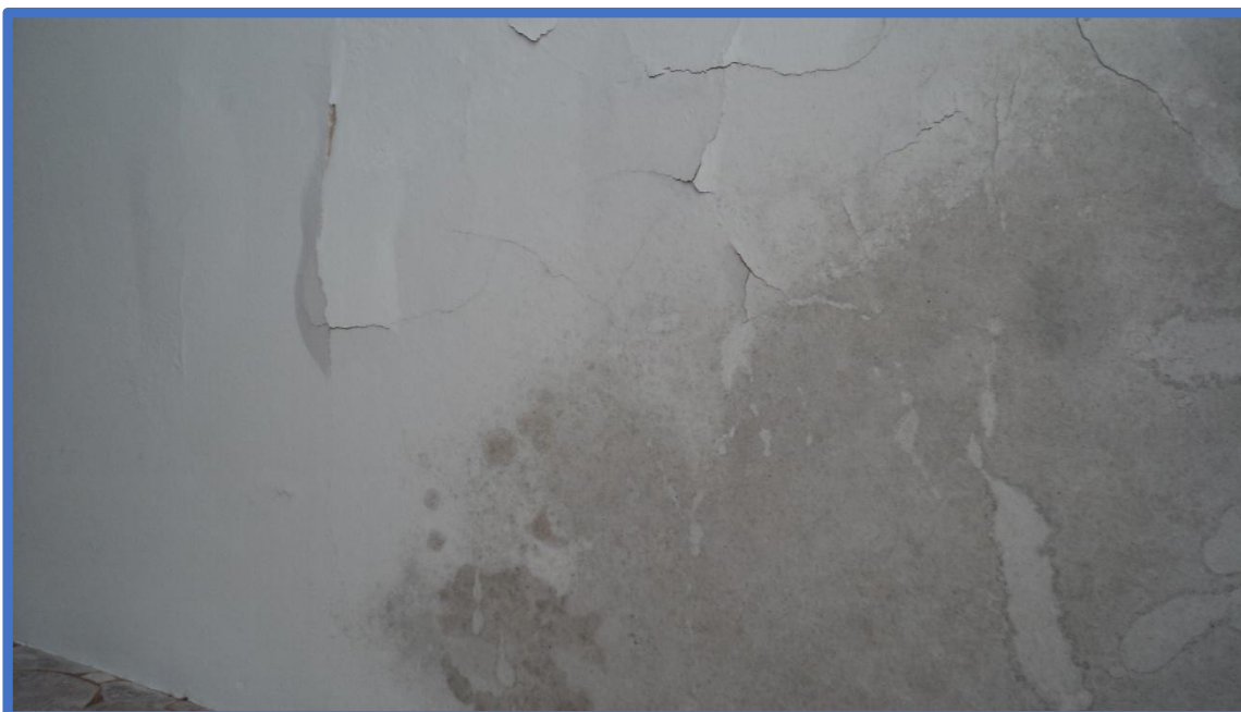
Foto: Visão da sala, e teto com infiltração.
