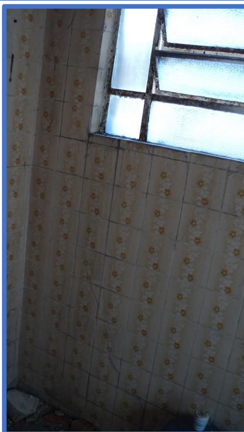
Foto: Visão da laje com ferragens expostas, com risco de ruína. Visão de azulejos com fissuras, indicando recalque diferencial.
