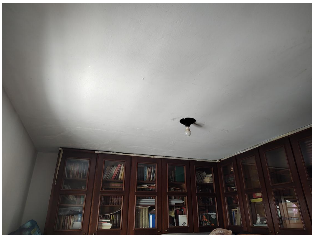
Laje de dormitório com fissura reparada
