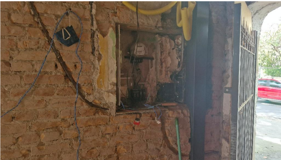
Foto do quadro de luz em péssimo estado de conservação.
