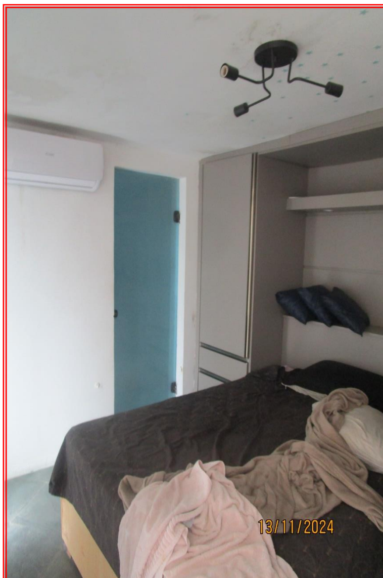
Foto nº 32: Vista parcial da antiga sala, atualmente utilizada como dormitório. O ambiente apresenta vestígios de infiltração no teto e paredes.
