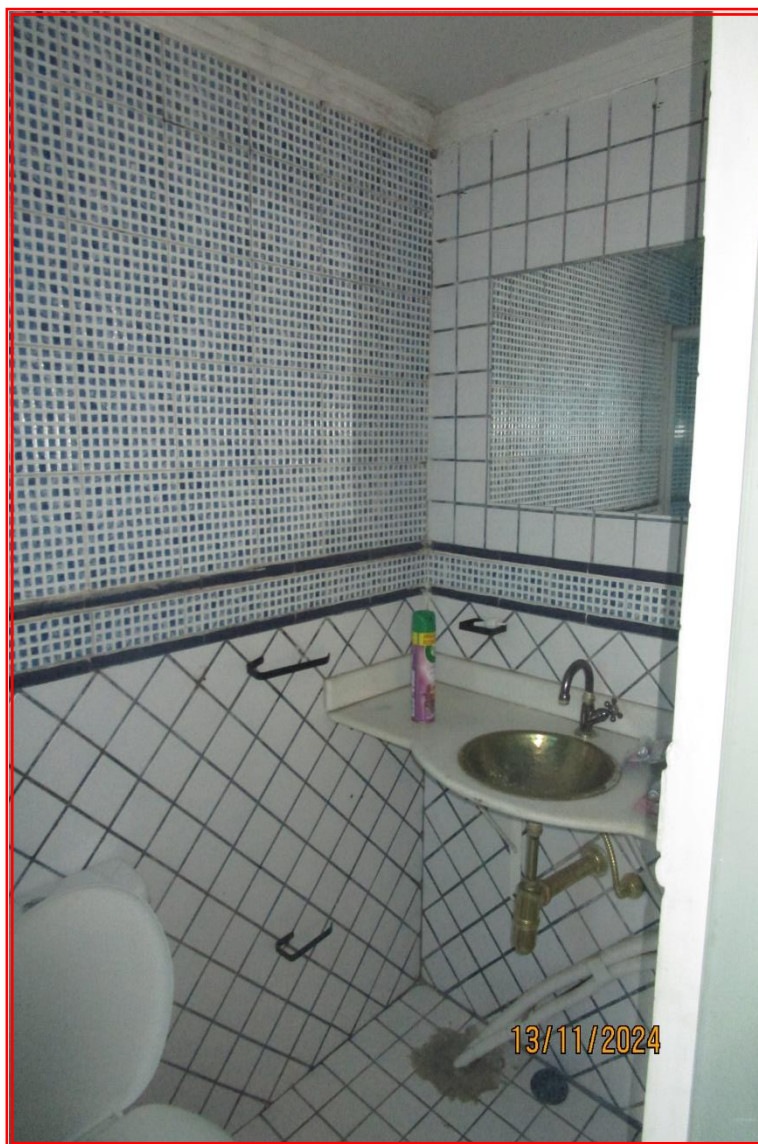
Foto nº 34: Vista parcial do banheiro. O ambiente apresenta vestígios de infiltração no teto.
