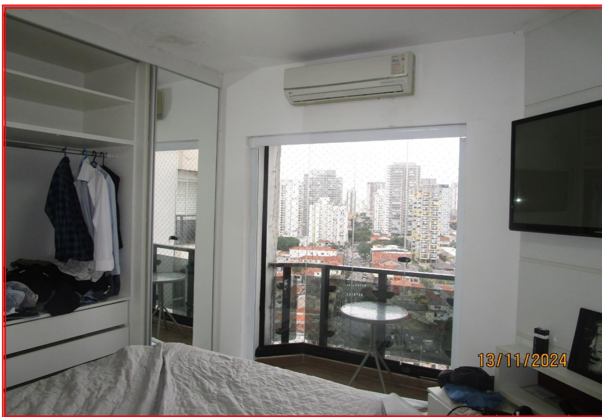
Foto n° 22: Vista parcial do dormitório 03 suite. O ambiente apresenta vestígios de infiltração no teto e problemas de vedação do fechamento de vidro da sacada.
