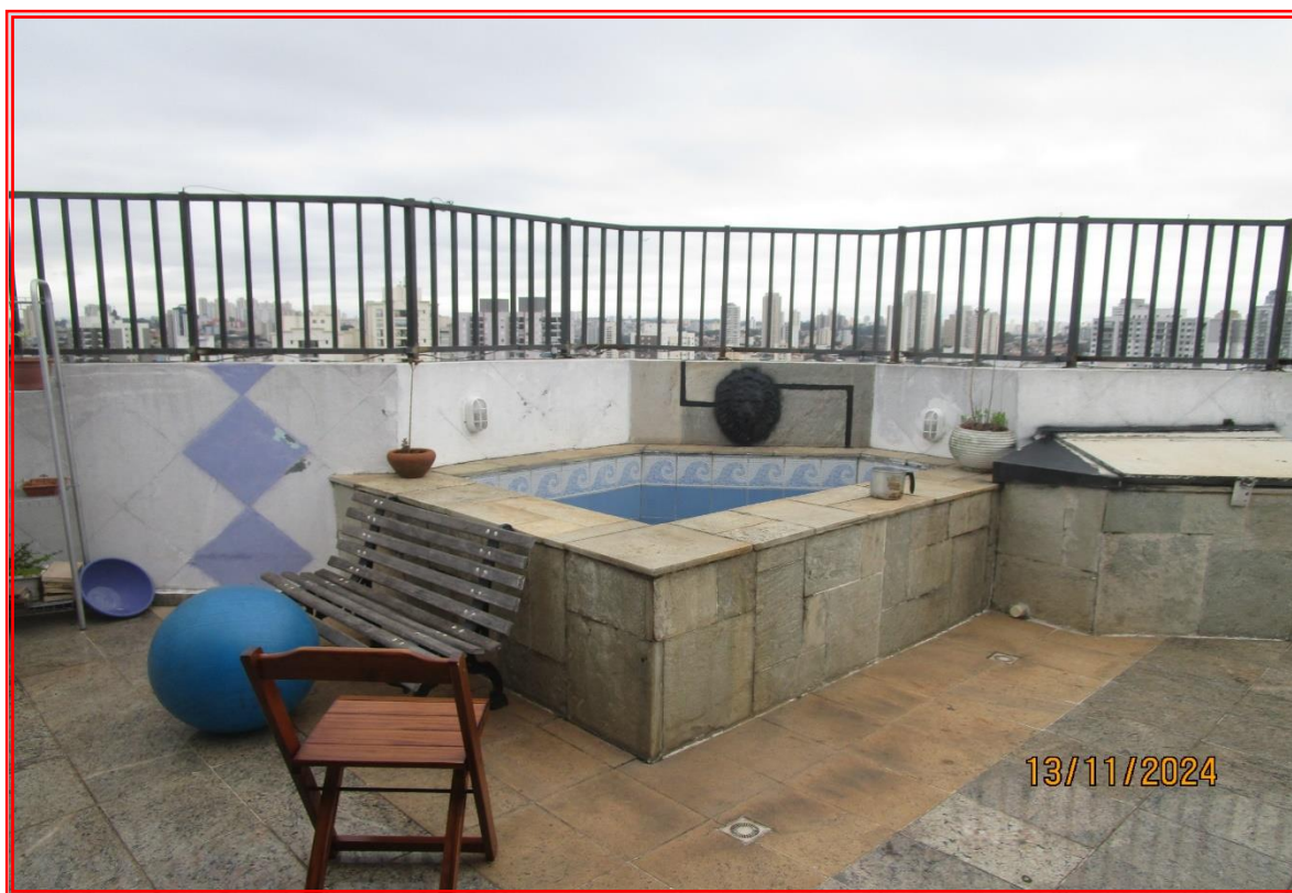
Foto nº 29: Vista geral da piscina. Segundo informações dos locatários, o ambiente apresenta problemas de vazamento.
