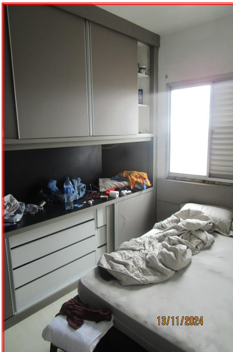
Foto nº 21: Vista parcial do dormitório 02. O ambiente apresenta problemas de vedação da esquadria.
