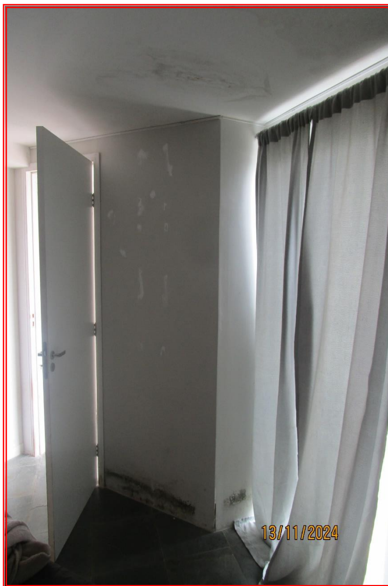
Foto nº 33: Outra vista parcial desse ambiente, com vestígios de infiltração no teto e paredes.
