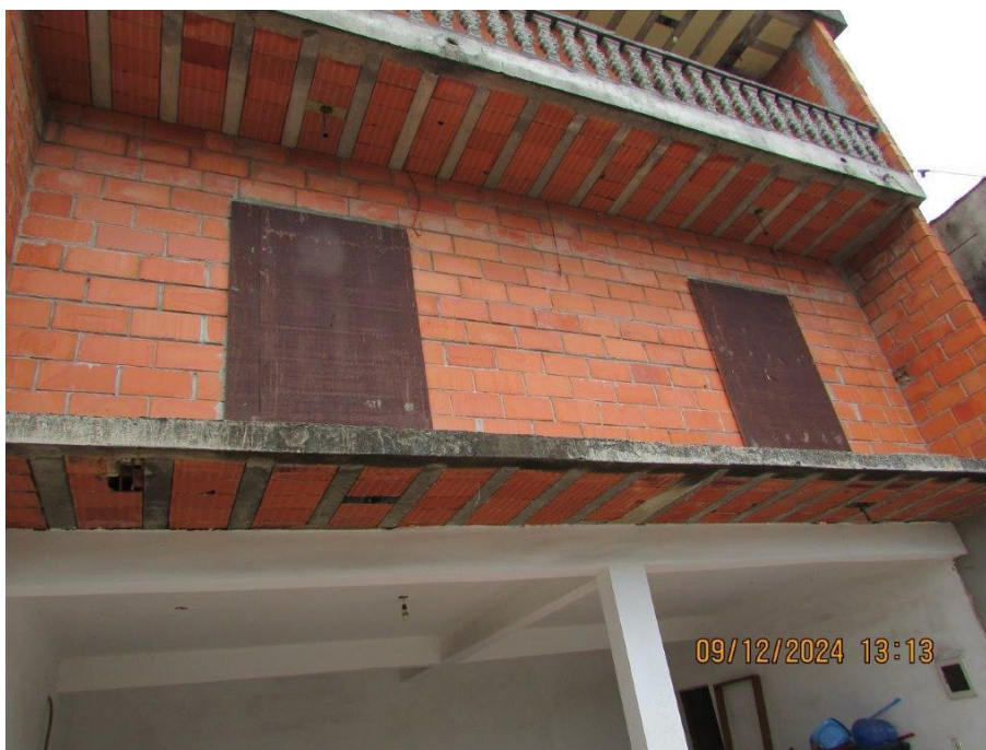
Foto 05: Vista parcial do teto sob a sacada, sem acabamento
